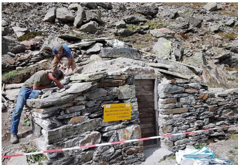
Refaite en 2020, la cabane abrite la source qui alimente l'Hospice. Photo © Yannick Levat
